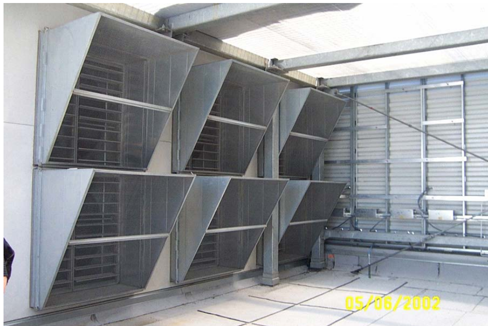
Figure 105. Relief Fan Discharge
